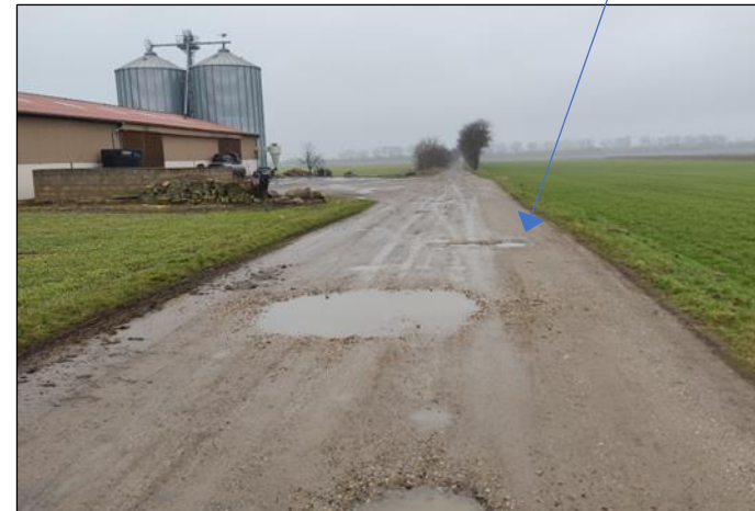
RW 11: Feldweg Kitzen-Meyhen „neue wassergeb. Decke“ - wichtige Ortsverbindung, kein Schutzgebiet - WGD bereits im Bestand unverträglich mit landwirtschaftlichem Verkehr
